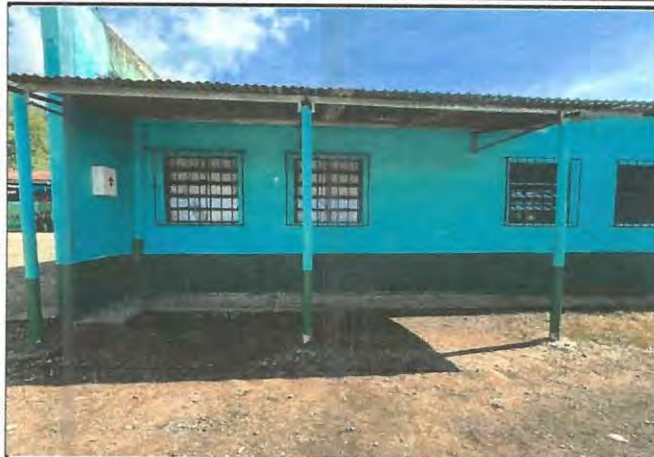
Foto 5 : Estado actual de la Galera primeros auxilios, se necesita instalación de piso y cambio de lámina troquelada calibre 26 y estructura metálica de techo.
