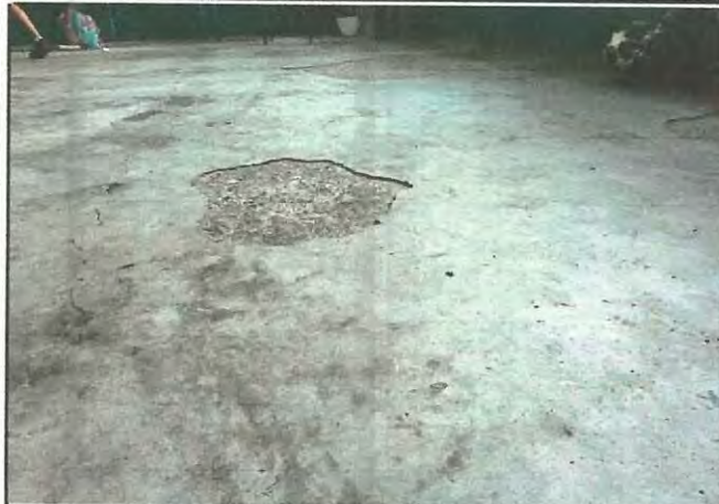
Foto 1: Estado actual piso aulas , se necesita el cambio de piso a piso cerámico.
