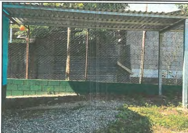
Foto 6: Galera para apoyo emocional en mal estado , se necesita el mejoramiento de la estructura tipo pórtico, lámina troquelada calibre 26 e instalación de piso
